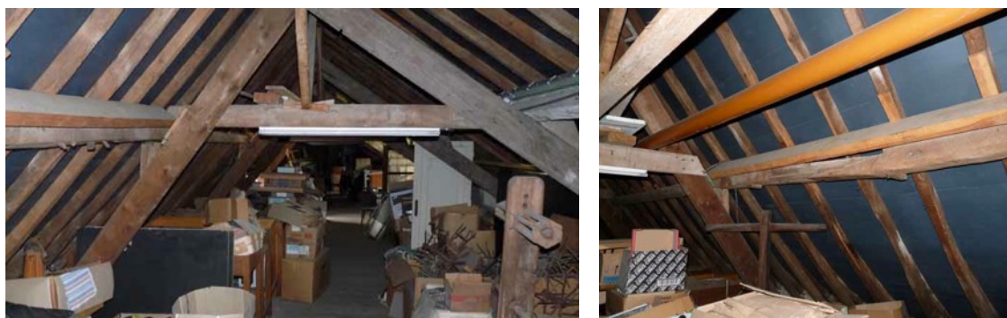
Figuur 71: de aanpassingen aan het dak gingen gepaard met een wijziging van dakhelling thv de noordzijde van de dakkap van het poortgebouwtje, ook de spanten werden vernieuwd. Figuur 72: thv dakvlak zuid werden alle structurelementen vervangen behalve 1 gording die hersteld werd
